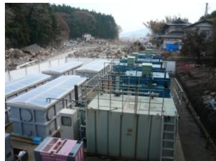
膜処理ユニット状況
