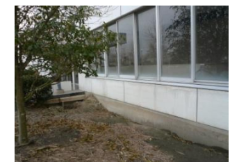
地盤沈下状況
