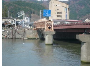
津波により抜け落ちた配管
