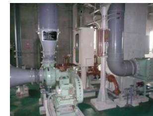
受電設備は生きており 主要な機器は動く
