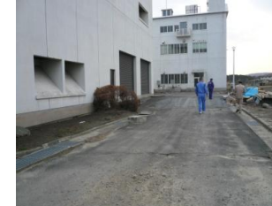
管理棟周辺の地盤沈下
