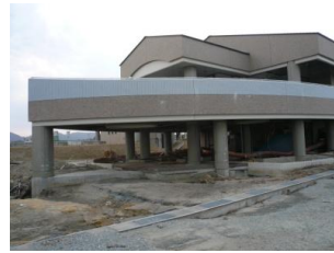
管理棟の被災状況
