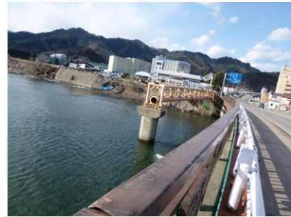
水管橋（污水管）の2/3が落下
