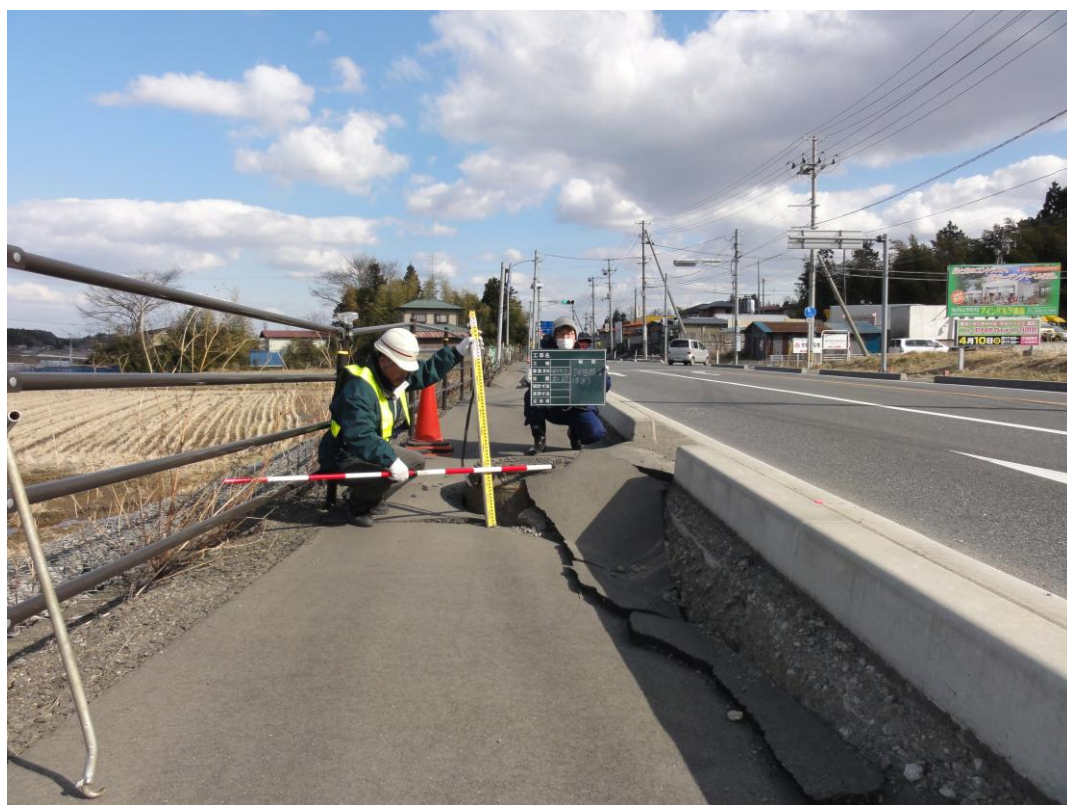
吉田川流域下水道 大和・大衡幹線（路面陥没）
