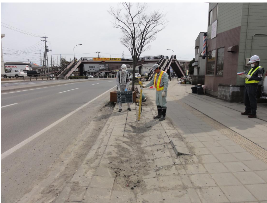
仙塩流域下水道 塩釜幹線 (路面陥没)
