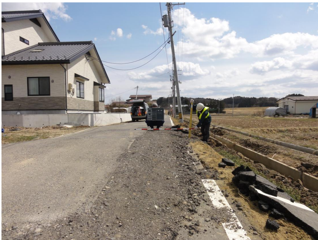
鳴瀬川流域下水道 放流渠（路面隆起）
