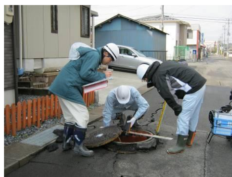
写真 3： 周辺地盤の沈下によるマンホール突出状況
